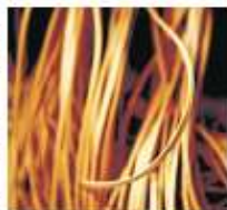
Kommunikationskabel im HLRS
